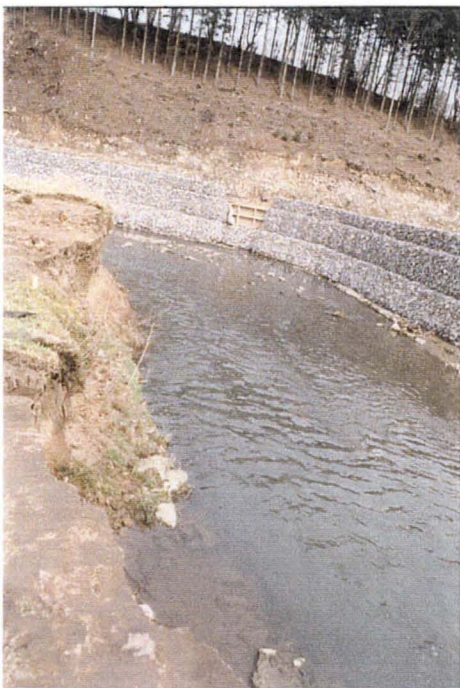
Photo 7: Etat de la berge à Plombières sur la Gueule avant les travaux (1996)
