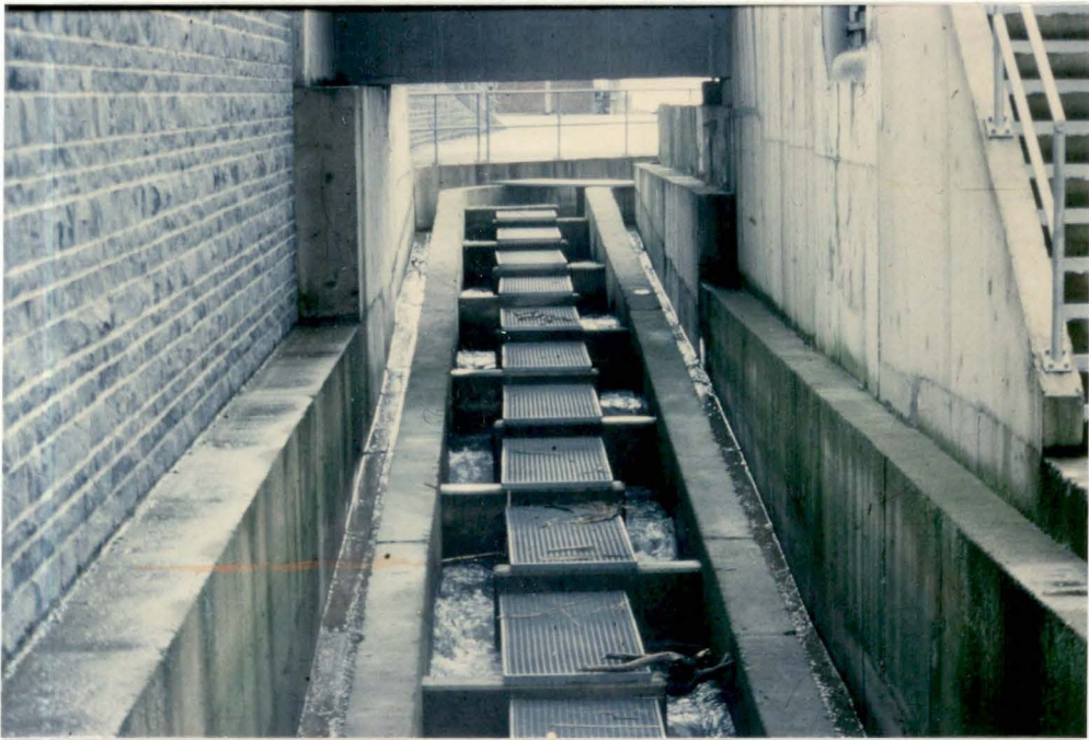
Photographie de la passe à poissons de TAILFER.
