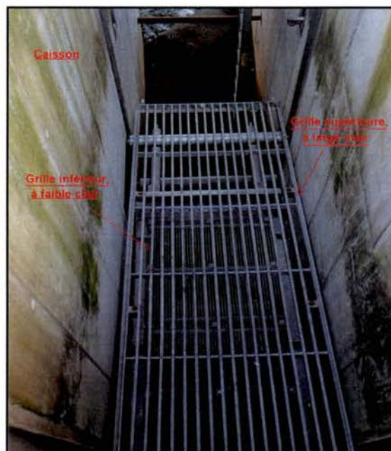
Figure 2. Grilles séparant les poissons des déchets. (Photo Rahier,2002)
