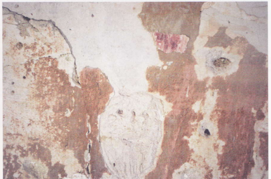
Fig. 10.- Chapelles du bras nord du transept, mur nord de la chapelle nord, fissure dans les mortiers et jonction entre le mortier jaune (à gauche) et le mortier blanchâtre (à droite). Le revêtement de faux appareil ocre jaune recouvre l'ensemble de manière homogène. © Aline Wilmet.
